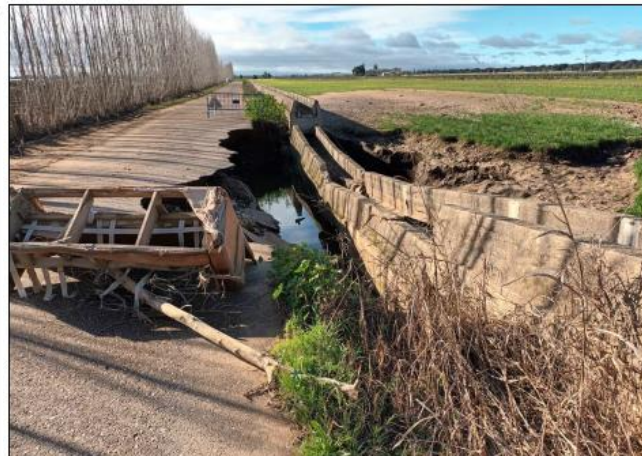
Tramo roto de la acequia "O"
