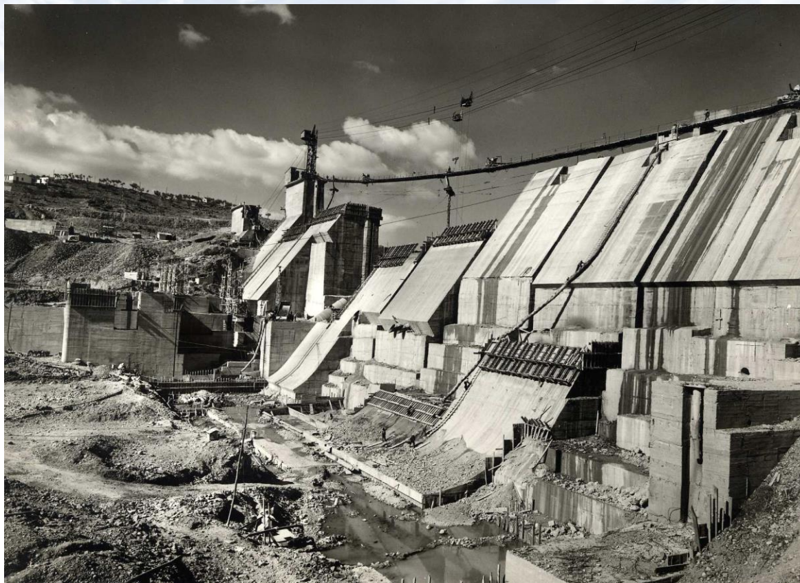
situación crítica durante la construcción, presa de Orellana 1959
