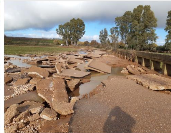
Tramo roto del camino de servicio de la acequia "P"
