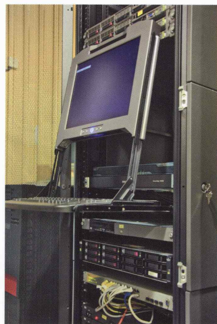
SOFTWARE DE CONTROL DE APLICACIONES SCADA
