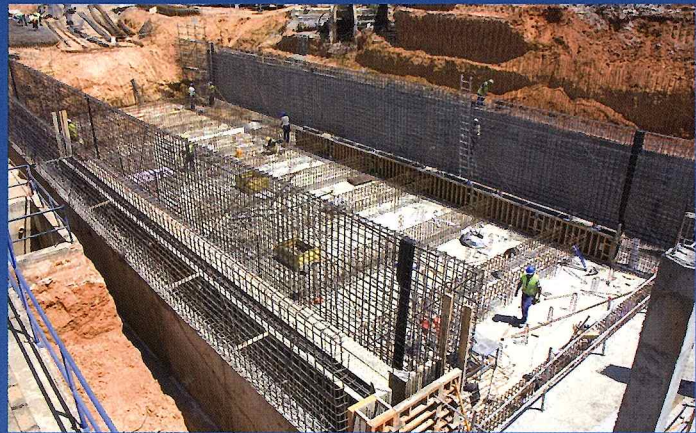
FILTRO DE ARENA
