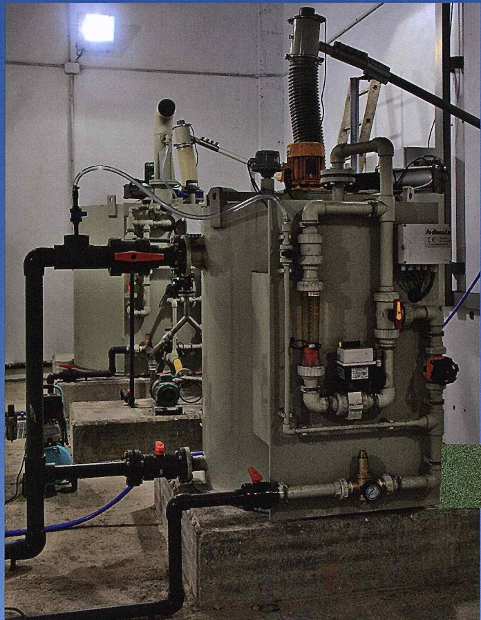
EQUIPO DE DOSIFICACIÓN DE CARBÓN ACTIVO
