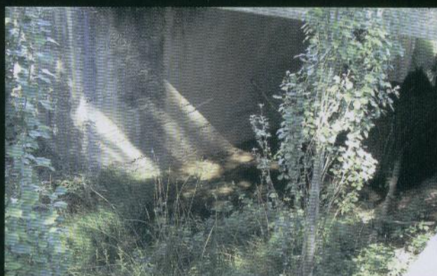
■ Obstáculos sobre una obra de paso en el Záncara (Cuenca)
