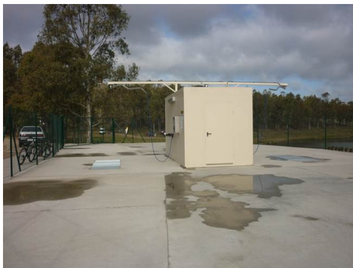
Ilustración 14. Estación Fija de desinfección de embarcaciones de la Confederación Hidrográfica del Guadiana 2. Fuente: Confederación Hidrográfica del Guadiana.
