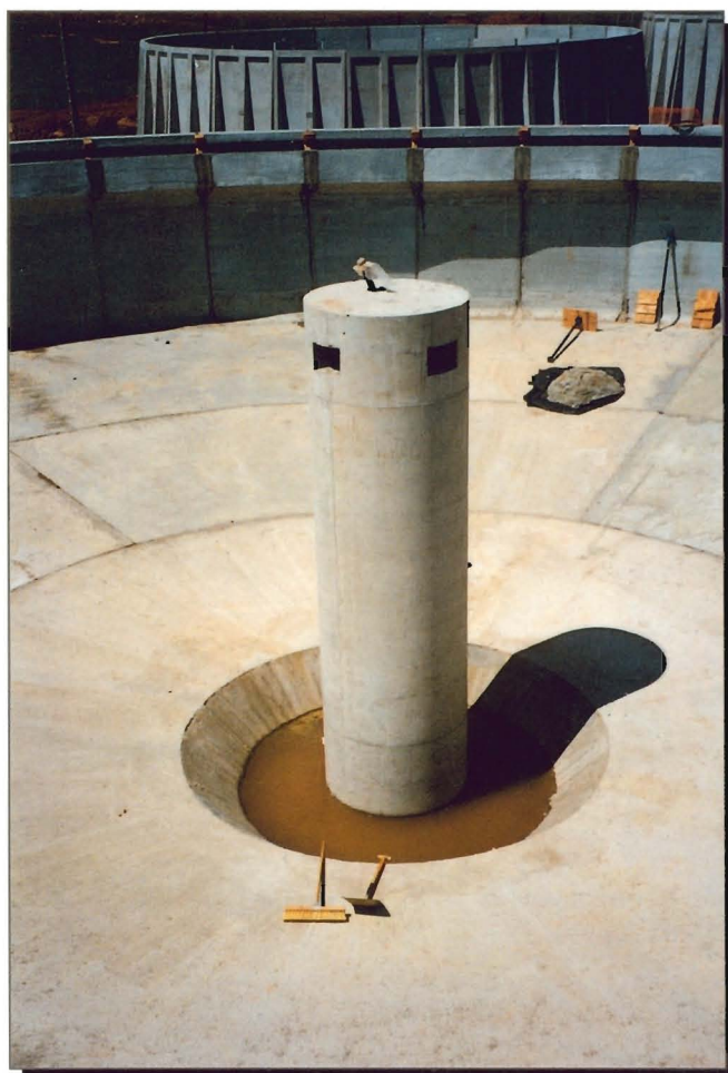
INTERIOR DECANTADOR SECUNDARIO
