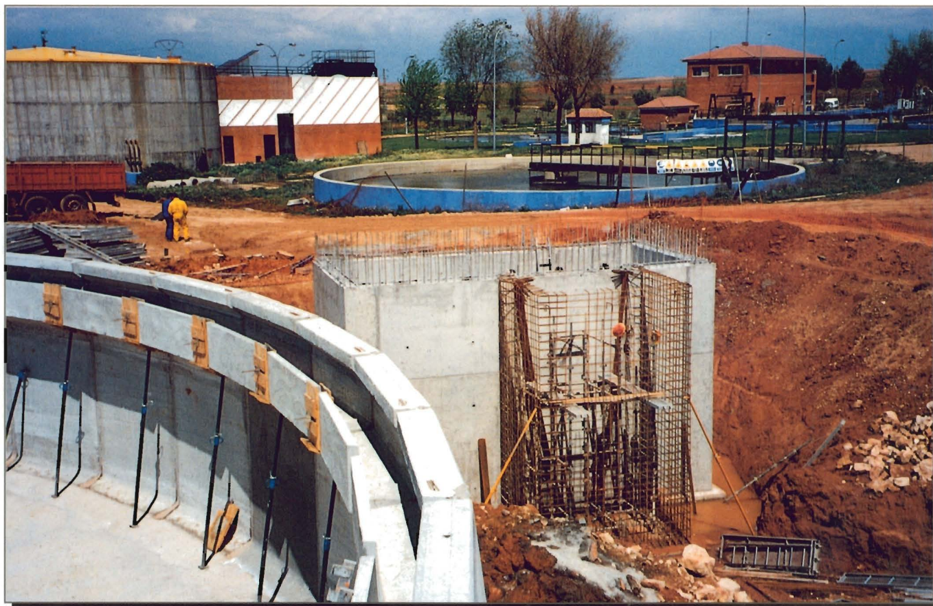
POZO DE BOMBEO DE FANGOS SECUNDARIOS
